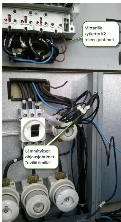
Kuva VII- 3 Esimerkki AMR-mittarin asennuskytkennästä. Yö-aikaohjaus (K2) kytkettynä mittariin. Keskussa valmiina olevaa teho-ohjausta ei ole kytketty mittarin releen liittimiin.
