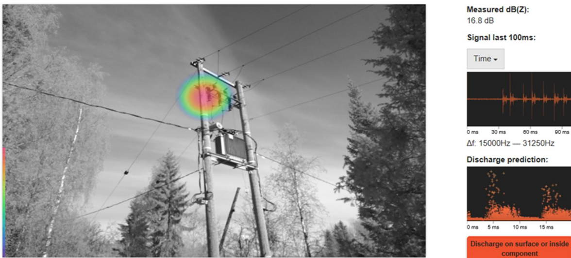
Kuva 4.10. Osittaispurkaus vaijerierotintimella varustetussa pylväsmuuntamossa (16.5.2019).
