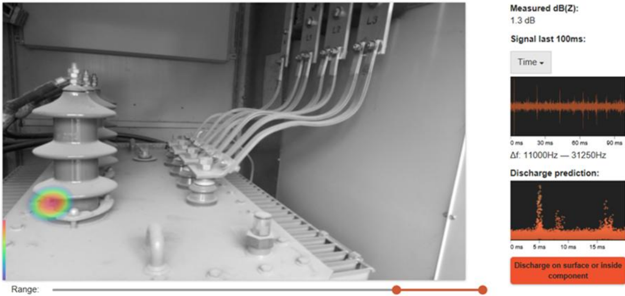
Kuva 4.9. Osittaispurkaus läpiviennin juuressa (7.5.2019, 7 °C, 65 %).
