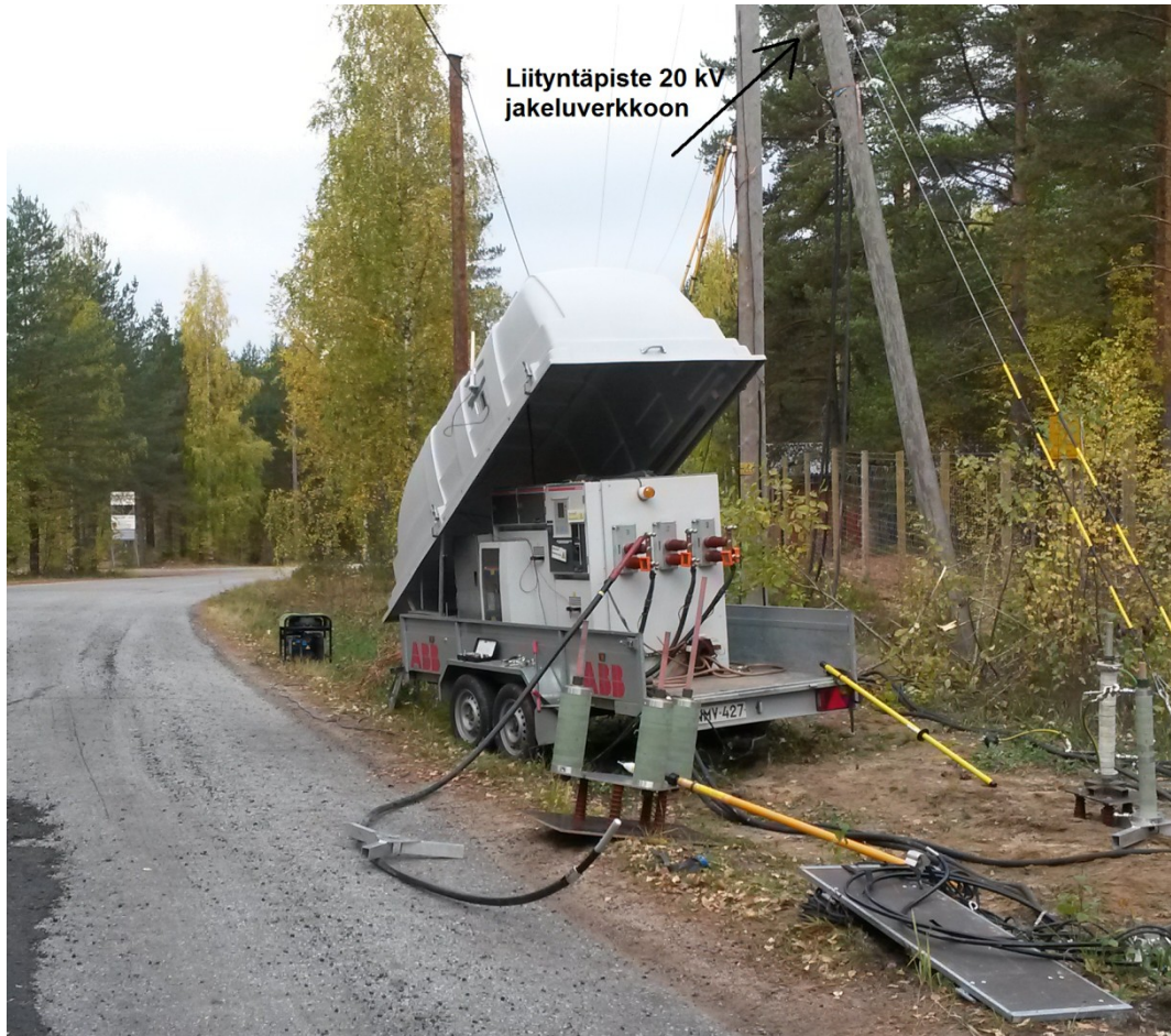
Kuva 8.2. ABB:n kehittämä vikakärri, jolla verkkoon voidaan tehdä keinotekoisesti sekä oikosulku-, että maasulkuvikoja. Vikatilanteena kuvassa on katkeileva maasulku kaapelilla.
