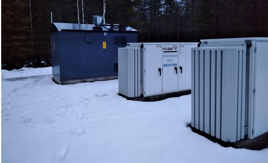
Kuva 3 Elenian akkuliityntälaitteisto (takana) ja Fortumin akustot
